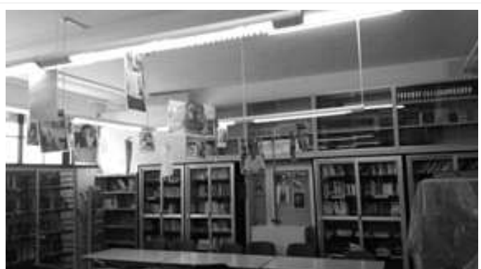
Fig. 8. Fluorescentes colgados del techo de la biblioteca.
