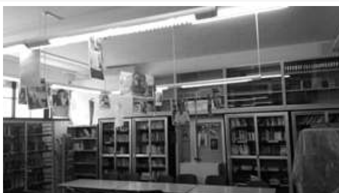
Fig.9. Fluorescentes recubiertos por un plafón.
